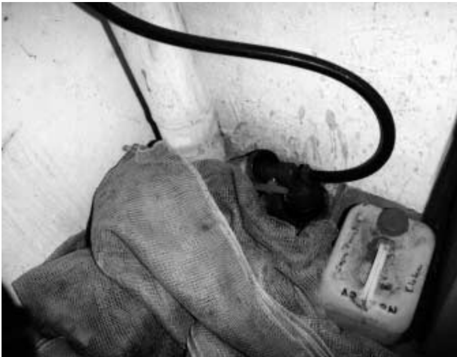
Abb. 4: In den Seitenstutzen des freiliegenden Abwasserrohres eingeführter Gartenschlauch
